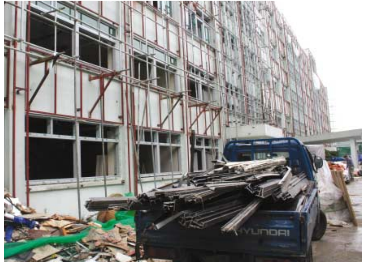
"지금은 공사중" ... 개강을 3일 앞둔 지난 달 31일 공사중인 학림관의 외관 모습. 학림관 내부공사는 현재 90% 이상 완료됐으며 외관공사는 9월 말까지 계속될 예정이다. 김나리 기자 viki26@dongguk.edu
